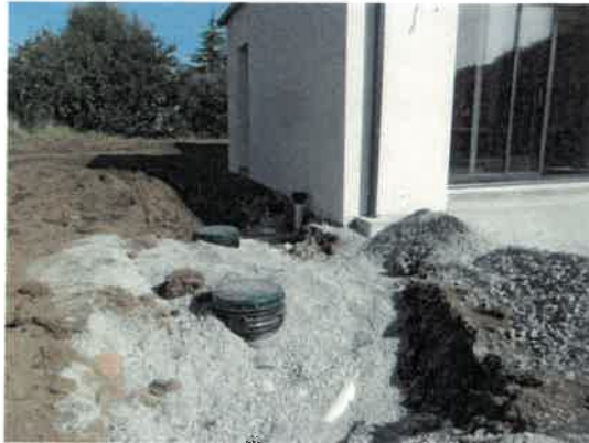
Fosse Toutes Eaux
